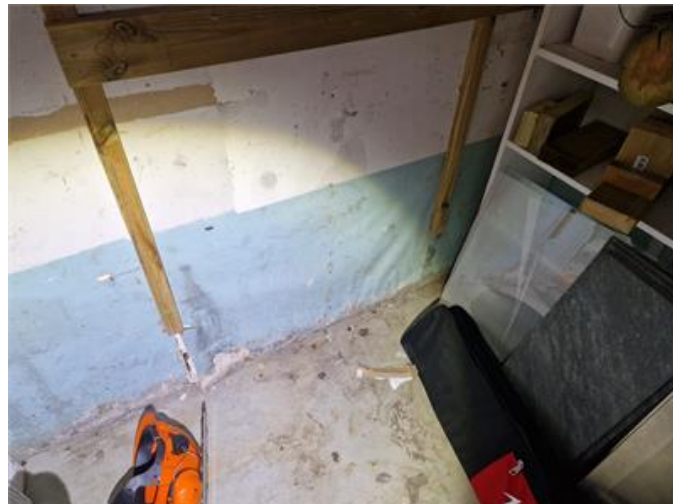
Garage: Fuktskada förekommer i vägg.
