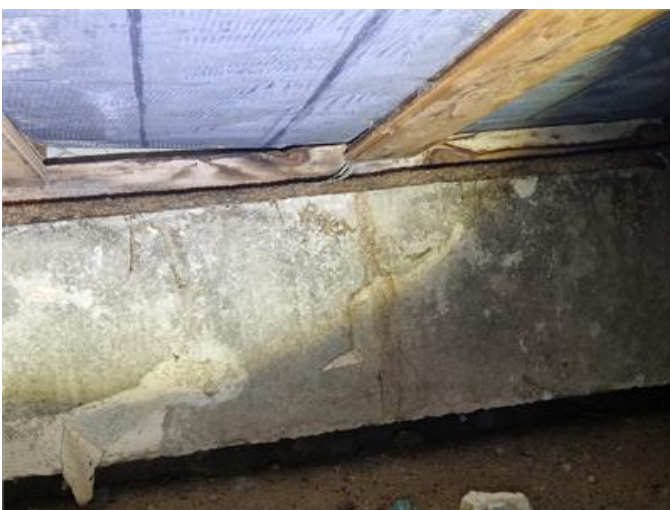
Krypgrund: Fuktfläckar förekommer på begränsad del av syll.
