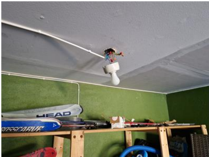
Garage: Bristfällig elinstallation förekommer i tak.
