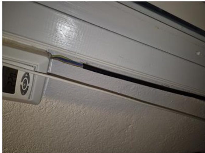
Bild på elinstallation.
