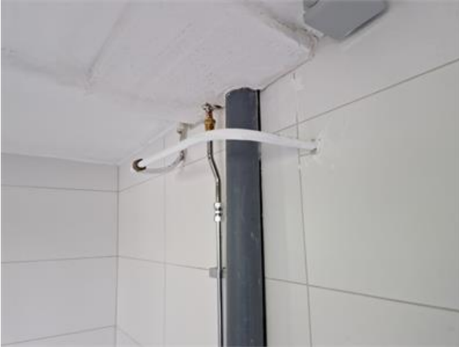
Dusch/Wc/Tvätt: Rördragning ej placerad mot vägg
