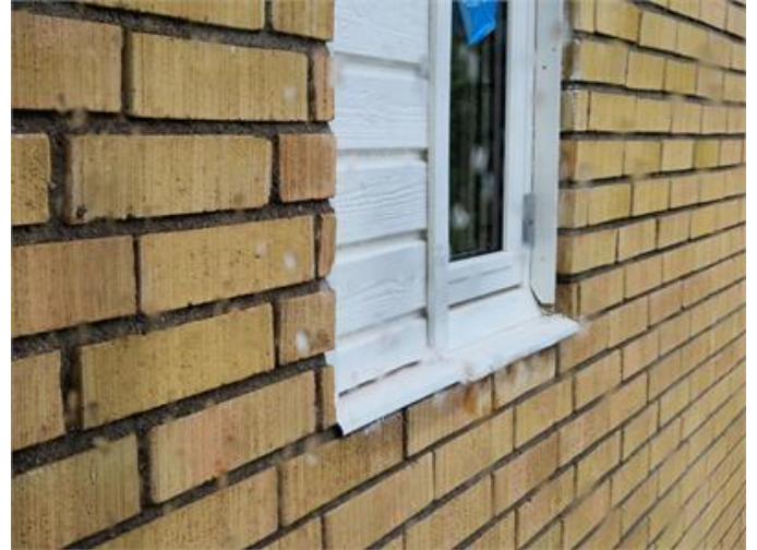
Fönster och Dörrar: Fönsterbleck skarvat och saknar erfoderligt överhäng mot fasad.
