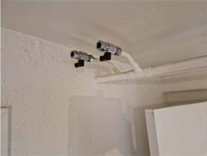
Tvättstuga: Röravstick ej pluggade. Endast avstängningsventil.
