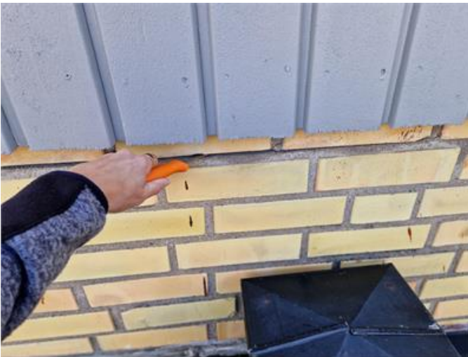
Fasad: Sprickor i fog och övre tegelraden på gavel ovan garage är lös.
