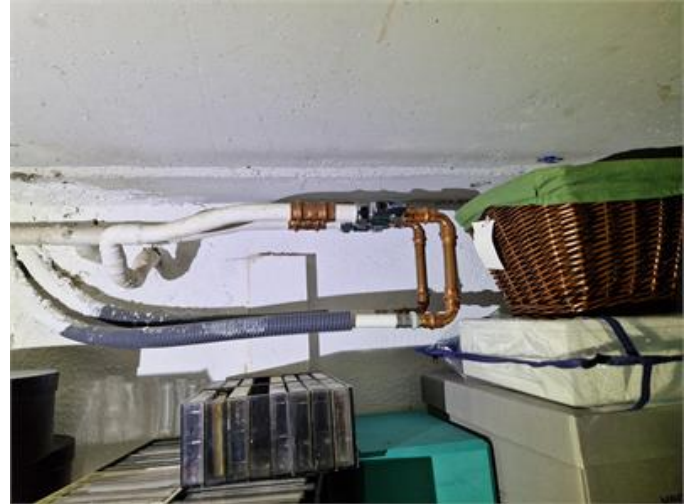
Förråd 1: Ej klamrade vattenrör förekommer.
