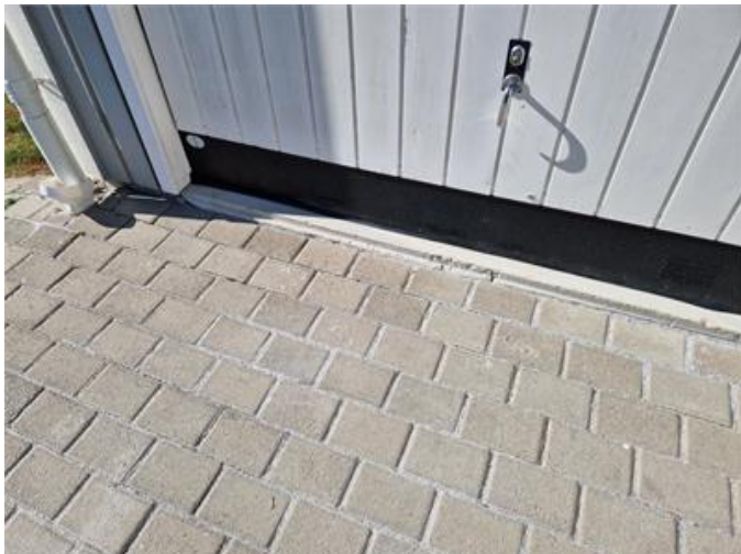
Garage: Skarp kant/ej fasad kant på betongplatta vid garageport.
