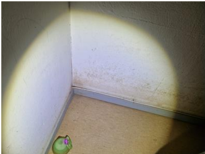
Klädkammare: Missfärgningar förekommer på vägg.
