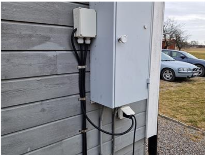
Fasad: Funktion/installation av elinstallation på fasad bör kontrolleras.
