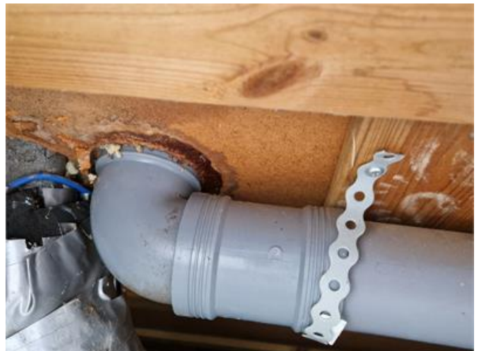
Plintgrund: Fuktmärken noterades kring avloppsrör från kök.
