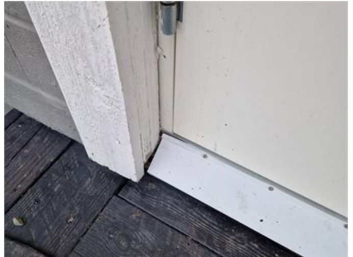
Fönster och Dörrar: Tröskelbleck under entrédörr saknar uppvikta gavlar och sitter ej korrekt monterat.
