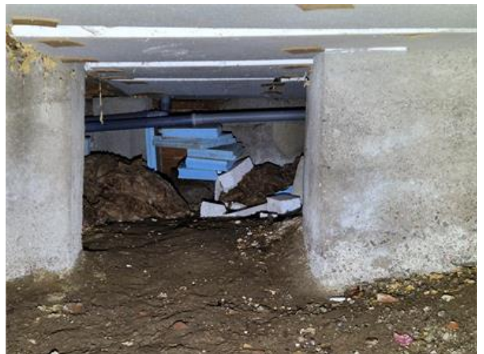
Plintgrund/Krypgrund: Ej korrekt förankrade rörintallationer
