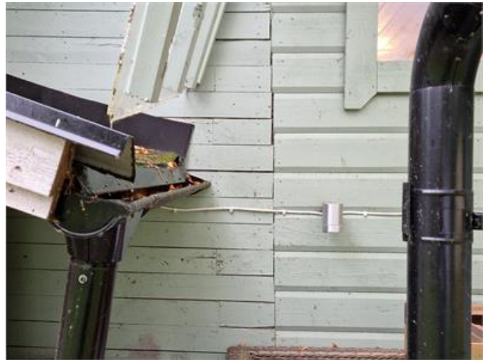
Fasad: Fasadpanelen är olämpligt skarvad.
