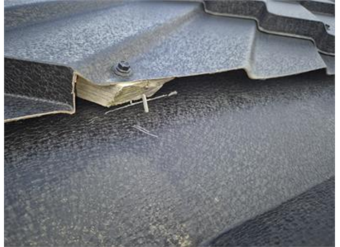
Läkt synlig i ränndal.
