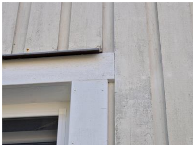
Fönster och Dörrar: Enstaka överbleck kortare än foder.
