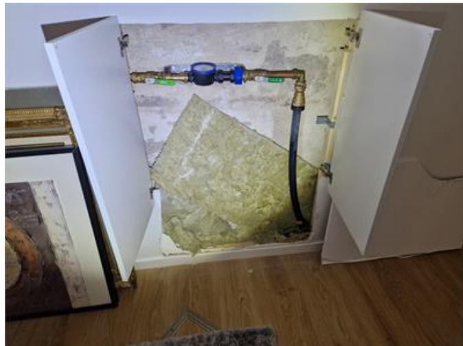
Rum 2: Installationsutrymme för vattenmätare/vatteninstallation saknar fuktskydd/vattenavledning.
