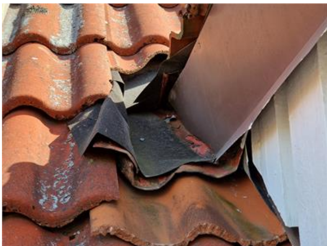
Tak: Brister noterades i rännalar.
