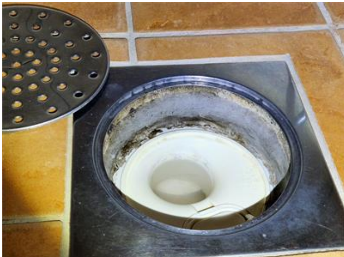
Dusch/Wc: Tättskiktsanslutning mot golvbrunn ej möjlig att inspektera
