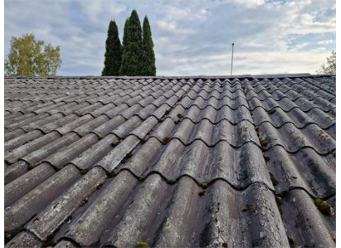
Tak: Taket är av äldre standard, brister förekommer,
