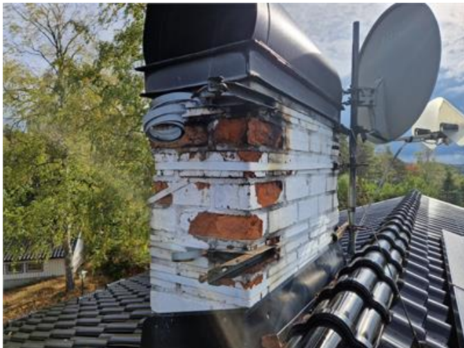
Tak: Vittrat tegel förekommer på skorstenskrona.
