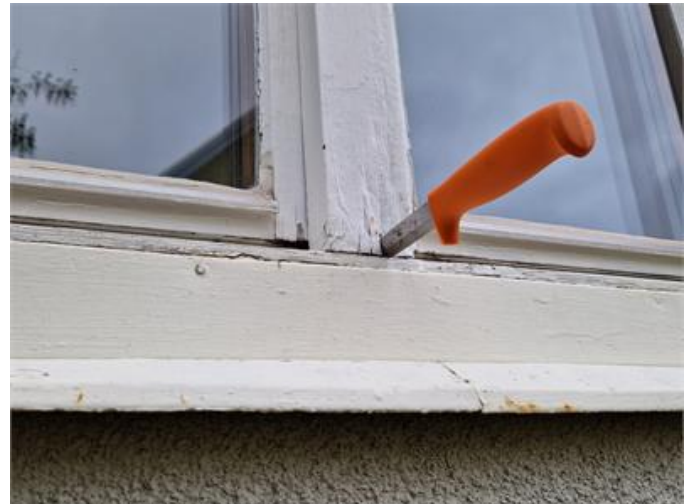
Fönster: Rötskador förekommer i flera fönster.
