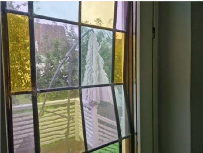
Vardagsrum: Blyinfattat fönster har delvis vikt sig.
