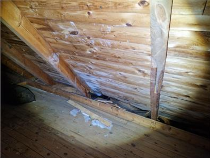
Vind: Fuktgenomslag/Missfärgningar förekommer i underlagstak.
