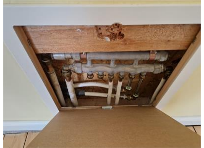
Sovrum 3: Installationsutrymme för vatteninstallationer saknar fuktskydd.
